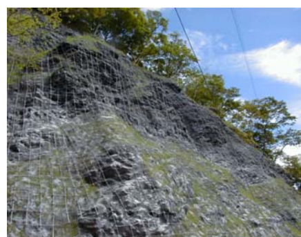
同左(落石防止柵工)
