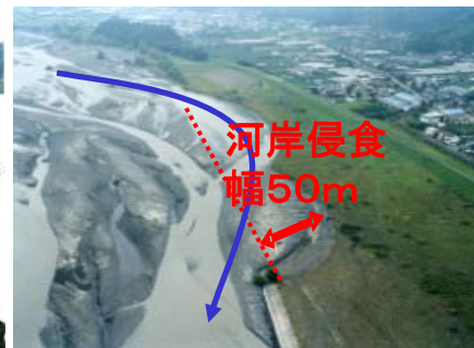
洪水による河岸侵食の状況 (平成12年9月洪水:静岡市福田ヶ谷地先)
