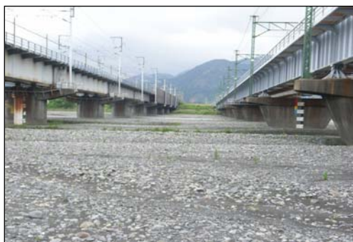
土砂堆積による河床上昇の状況(新幹線とJR在来線)
