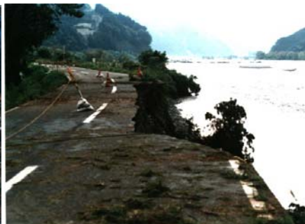
洪水による堤防の被災 (平成3年8月洪水:静岡市俵沢地区)
