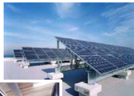
太陽光発電設備
