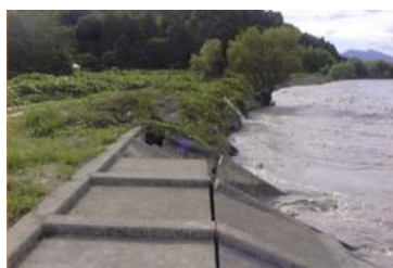
平成25年9月洪水の被災状況 (鎌塚地先)
