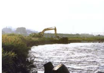
平成24年9月洪水の被災状況 (中河地先)
