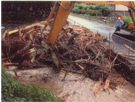
用水マスに流木が堆積（旧藤橋村東横山）
