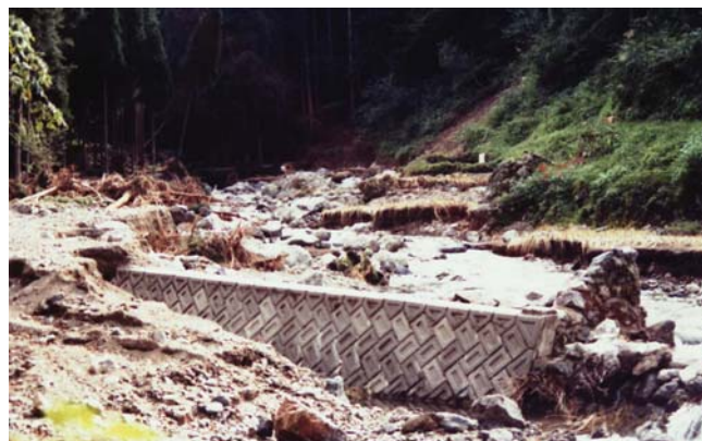
高知川の護岸決壊状況（旧久瀬村）
