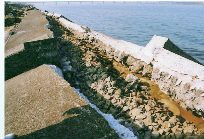
兵庫県南部地震で液状化現象により壊れた淀川の堤防 (提供:近畿地方整備局淀川河川事務所)
