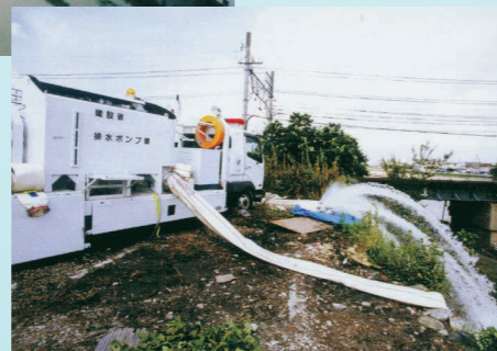
平成12年9月の東海豪雨 時に活躍する排水ポンプ車 (庄内川水系新川)
