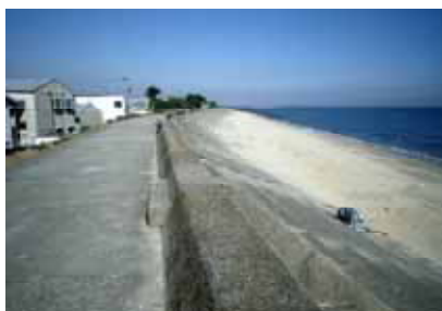
空洞化がみられる老朽化した堤防(整備前)
