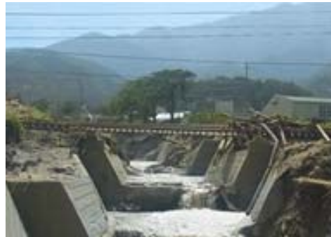
JR鉄道橋の流失
