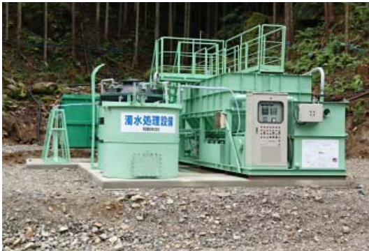
濁水処理施設
