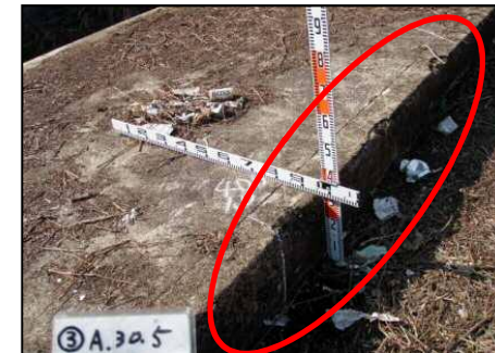
沈下による段差
