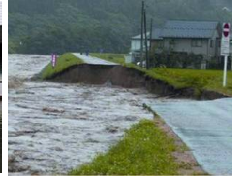
H18.7災害 堤防決壊(箕輪町松島地区)
