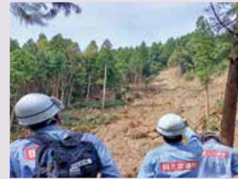
②-1 法面崩落箇所の被災状況調査(被害情報を迅速に把握)
