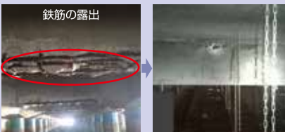
栈橋式岸壁の老朽化状況と対策
