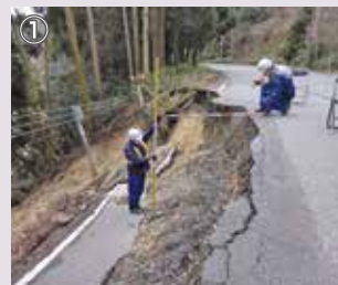
法面前落箇所の被災状況調査 (石川県志賀町大福寺)
