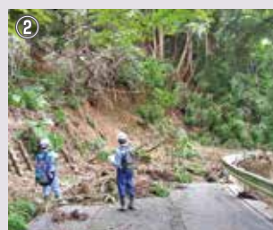
法面前落箇所の被災状況調査 (秋田県由利本荘市)
