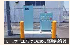
リーファーコンテナのための電源供給施設
