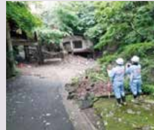
道路の被災状況調査
