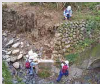
護岸崩落箇所の調査 (川根本町)
