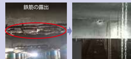
栈橋式岸壁の老朽化状況と対策
