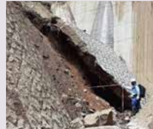
砂防施設の被災状況調査
