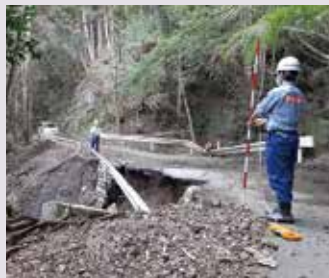
道路法面崩落箇所の調査 (島田市)
