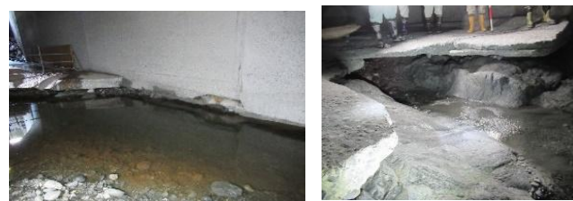
図-7 呑口直下の勾配変化点周辺摩耗状況
