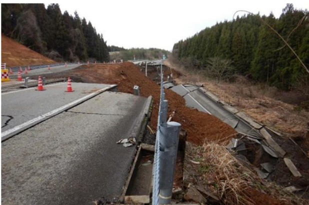
図1 令和6年能登半島地震における盛土被害の例
