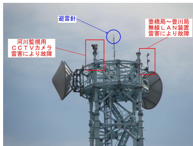
写真-4 豊川流域治水出張所 鉄塔被災設備
