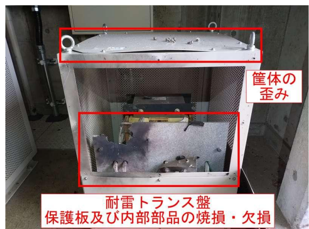
写真-2 遠望峰無線中継所 耐雷トランス盤
