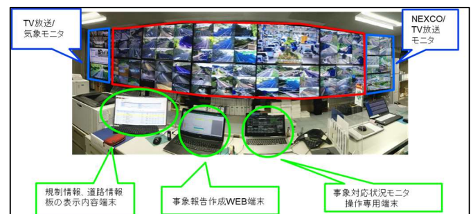
図-3 高規格道路管理センターにおける情報収集の状況
