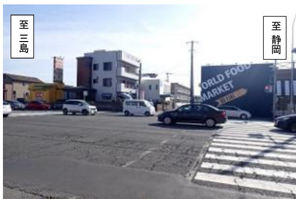
写真-2 花園町交差点の舗装損傷状況
