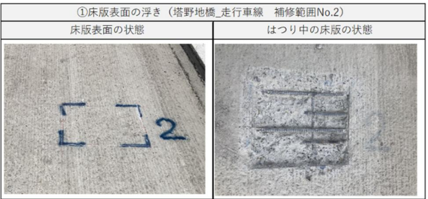
図-5 床版の浮き
