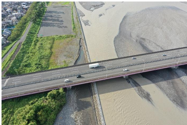
図-3 高水敷被災箇所の全体把握状況
