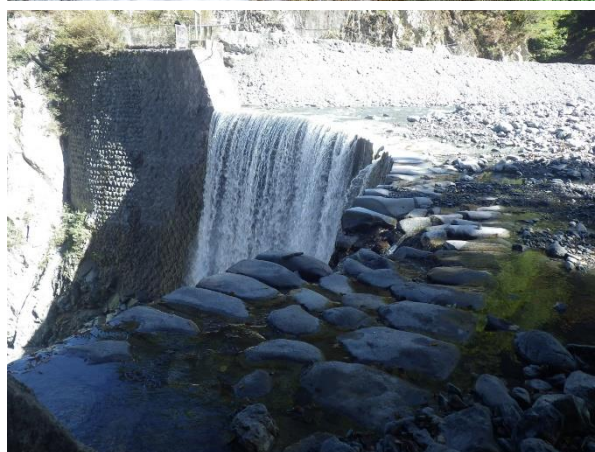
写真-3 上蔵砂防堰堤欠損箇所 上空から撮影（上） 左岸側から撮影（下）
