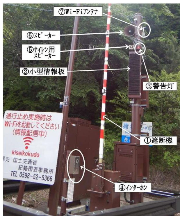
写-1 遠隔遮断機
