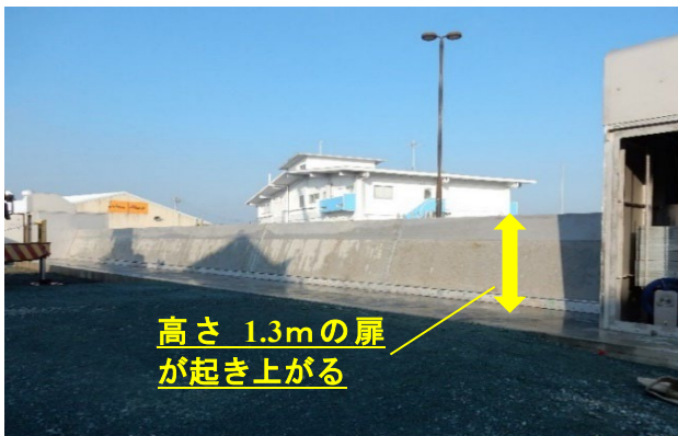
写真-9 フラップゲート式陸閘（起動時）
