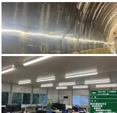
図-7 LED照明設置状況（坑内及び事務所）
