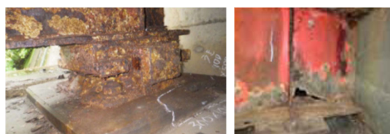
写真-2 桁端部の損傷状況
