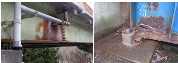
写真-1 管内橋梁の損傷状況
