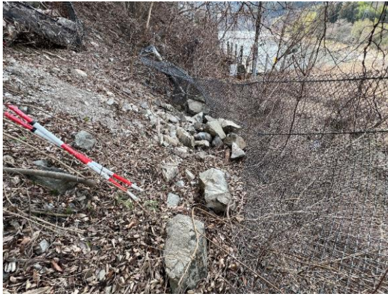
写真-1 損傷した落石防護柵
