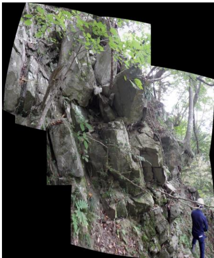
写真-2 不安定な浮石
