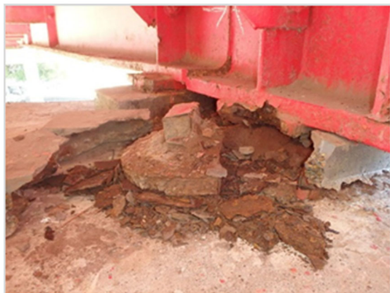
図-2 支承部の損傷状況
