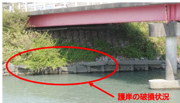
図-7 A2橋台前面護岸の破損状況
