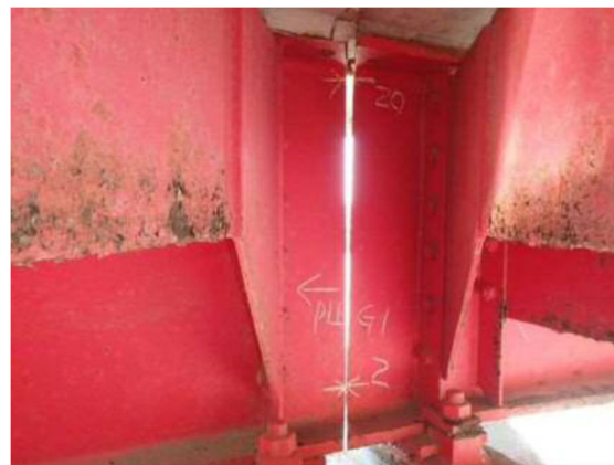
図-5 主桁の遊間異常
