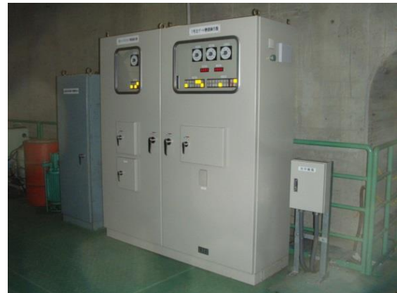
図-5 機側操作盤（オリフィスゲート）
