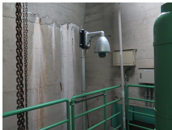
図-10 簡易カメラの設置状況（オリフィスゲート）
