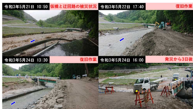
写真-4 仮橋と迂回路の被災
