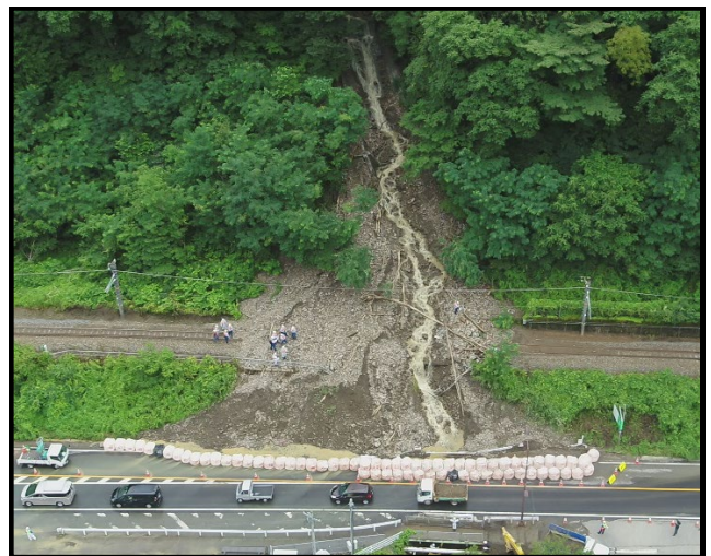
図-5 大型土のう設置による片側交互通行の様子 (⑥木曽平沢)
