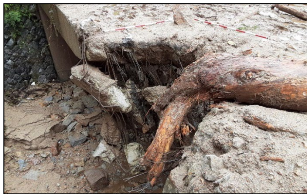
図-2 橋梁損傷状況（①須原北）
