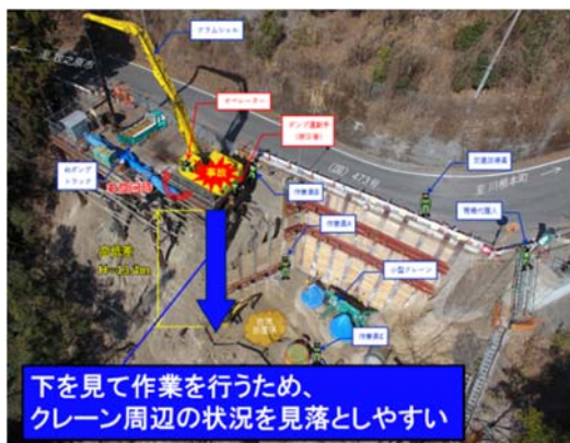
図-2 空中写真(事故発生現場)
