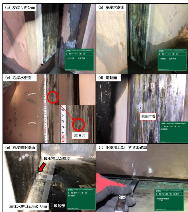
図-3 副ゲートフレーム状況
