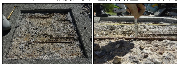
写真-1 床版上面の損傷状況 (前回点検時)
