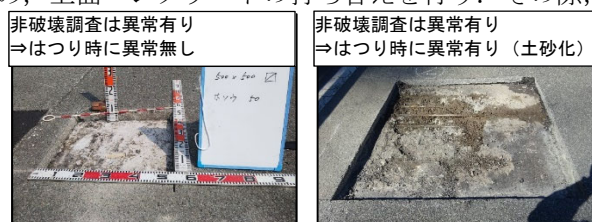
写真-2 床版上面状況(事前調査時)
