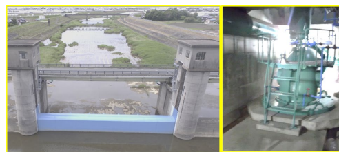
図-2 豊川放水路に設置されている機械設備の概観
