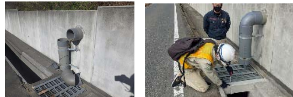
写真-2 (左: 損傷時 右: 完成時)
