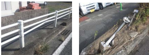
写真-1 原因者施行対象の道路損傷例
