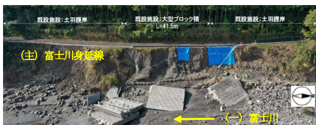
写真-1 被災状況(全体)
