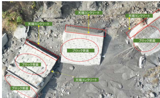
写真-6 大型ブロック倒壊状況
