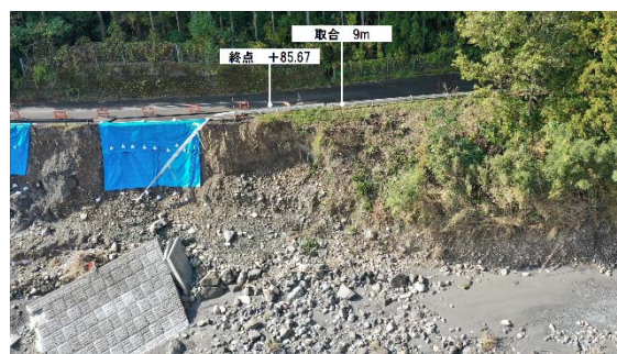
写真-4 被災状況(終点部)
