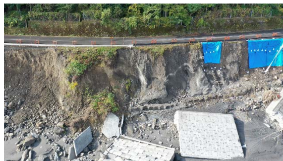
写真-3 被災状況(中間部)
