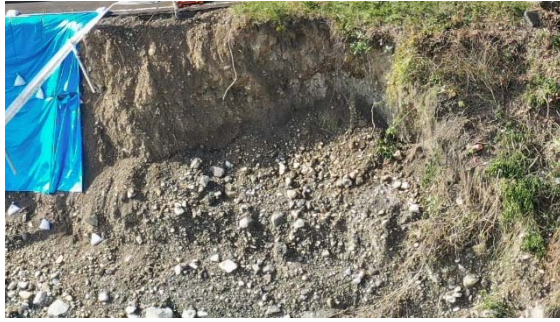
写真-5 被災状況(終点部拡大)
