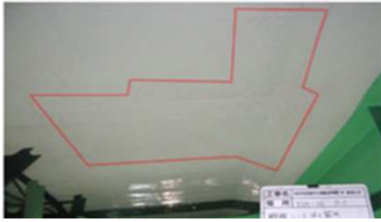
写真-2 繊維シート一部浮きの様子
