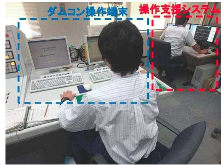
図-12 ダムコン操作端末と操作支援システム
