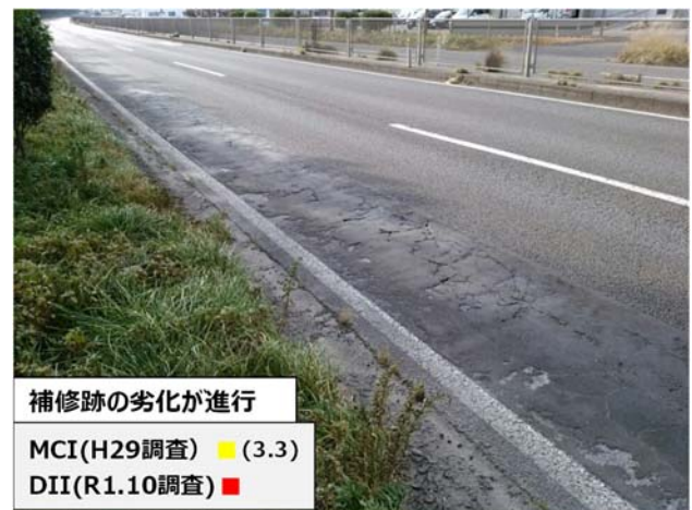
図-6 MCI から進行が進んだ事例
