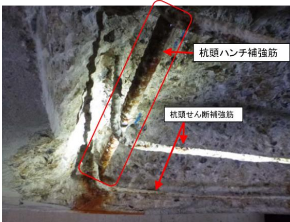
写真-4 杭頭ハンチ補強筋発錆状況 (図-3 ③)
