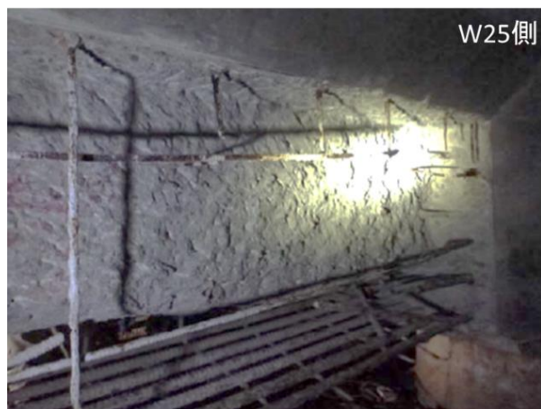
写真-8 梁部せん断補強筋腐食状況 (W25 側 図-3 ②)
