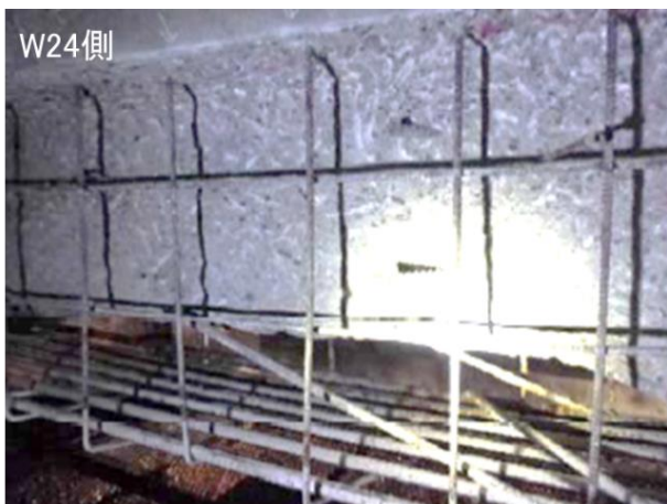
写真-7 梁部せん断補強筋腐食状況 (W24 側 図-3 ②)
