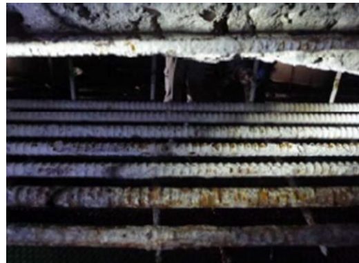
写真-6 梁部主鉄筋発錆状況 (図-3 ②)
