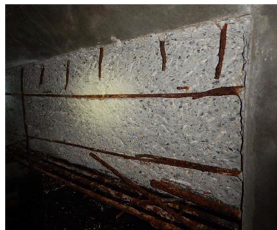
写真-3 現場状況図(W25 側梁部側面 図-3 (2))
