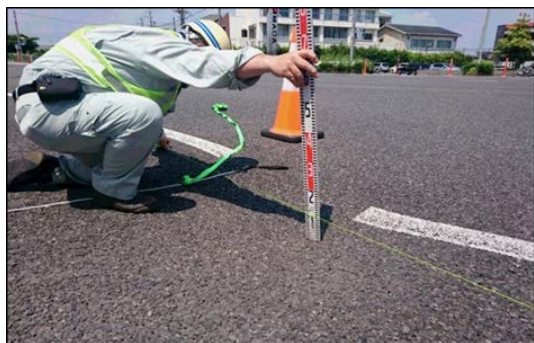
図-3 陥没状況（約 10cm）
