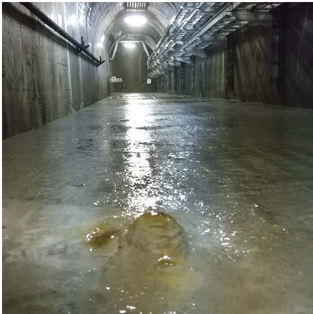
図-7 監査廊路面の遊離石灰
