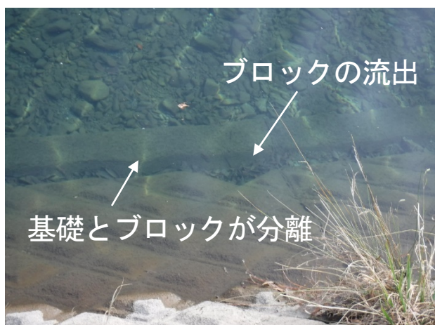
写真-2 基礎とブロックの分離状況（護岸天端から撮影）
