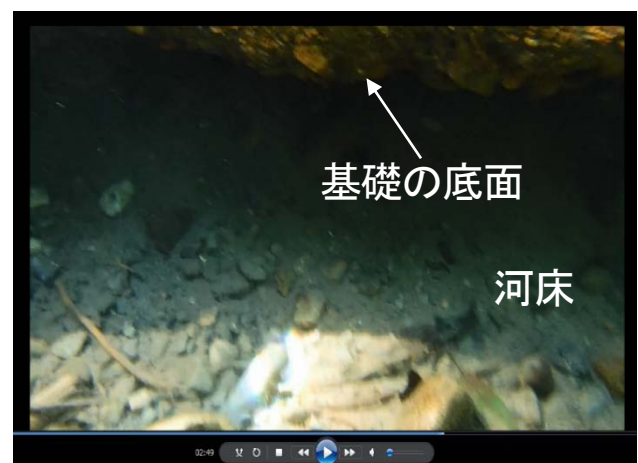
写真-3 被災基礎が浮いている状況（護岸正面から水中撮影）
