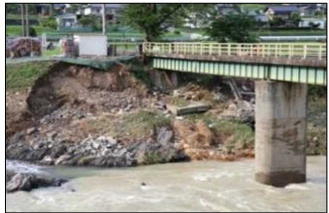
写真-1 東沓部護岸洗掘状況。
