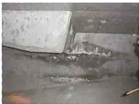
図-3 ウェブ水平打設目からの漏水
