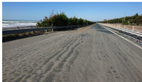
写真-2 路面への堆砂の様子
