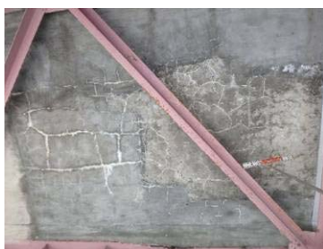
写真-3 前回点検時状況写真 (H28)
