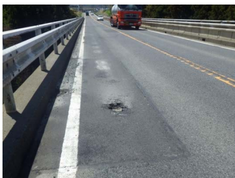
写真-1 繰り返し発生するポットホール
