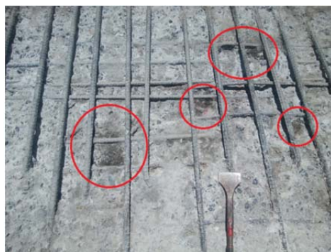
写真-2 劣化部の取り残し
