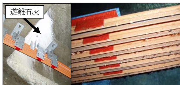
写真-2 不具合状況例（左：流出物付着、右：結露）
