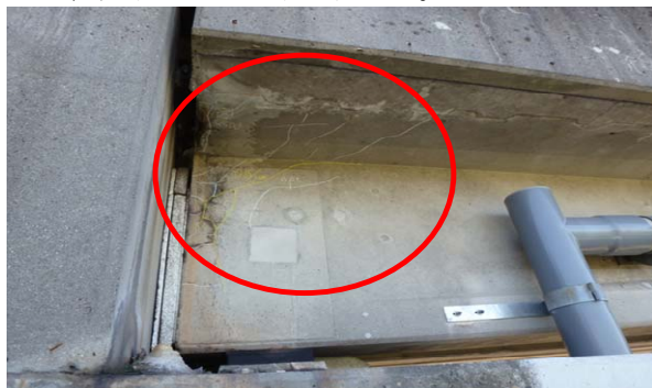
写真1. 桁端部のひび割れ状況
